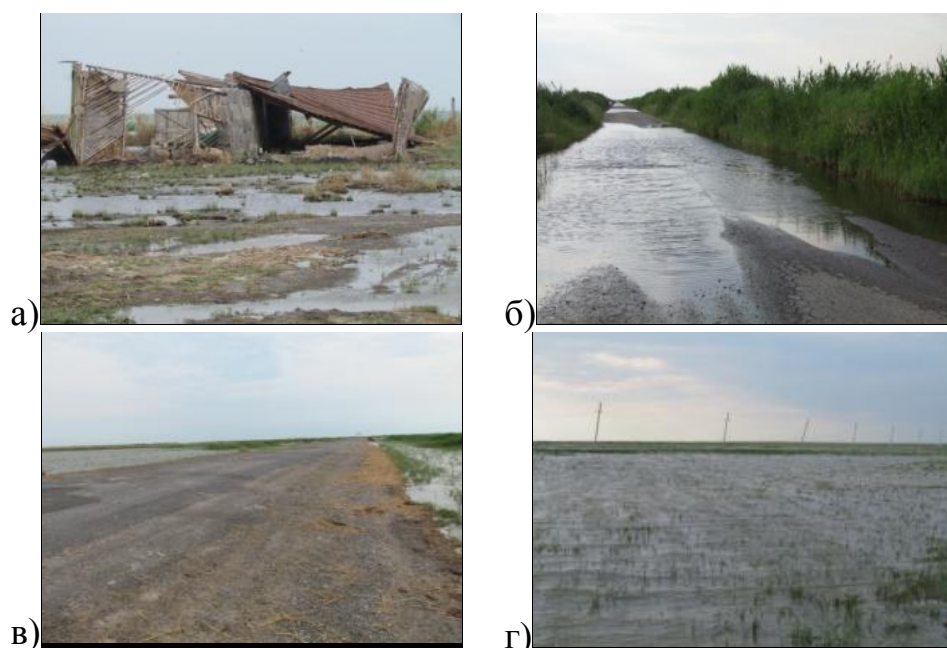
а) разрушенный рыбоприемный пункт с. Камыскала, затопление и подтопление селитебных территорий; б) затопление и подтопление автодороги Ушарал – Уялы; в) затопленная территория с обеих сторон дорожной насыпи автодороги Ушарал – Камыскала; г) затопленная ЛЭП
